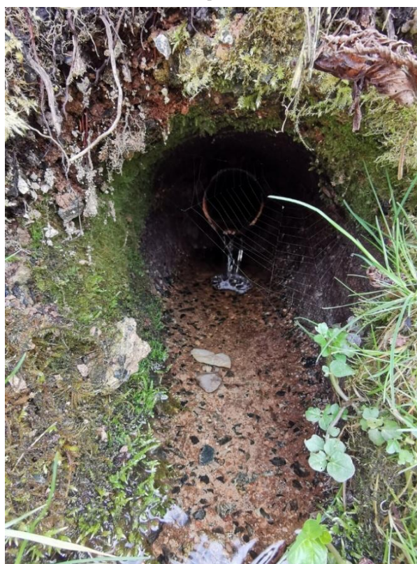
Obrázek 3 Tier2_Oberweißenbach_03.jpg – drenážní potrubí v dolní části plochy; zdokumentovaný zásah do vodního režimu
